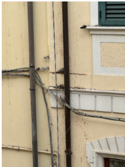
Gli effetti del guano di piccioni su un edificio di Corso Ovidio
